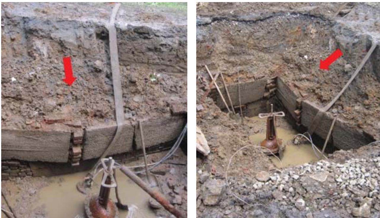
Рис. 18. Результат действия значительных давлений в элювиальных суглинках верхней части земной коры Екатеринбурга. Повреждение стенок из бетонных блоков в колодце по ул. Умельцев, 5 в г. Екатеринбурге. (Фото Осиповой А.Ю.)
