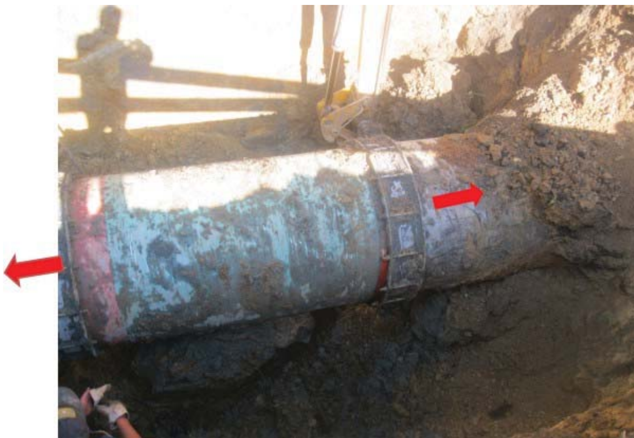
Рис.12. Иллюстрация действия значительных горизонтальных сил на трубы подземных водонесущих коммуникаций. Авария на водоводе диаметром 1000 мм на ул. Амундсена в начале августа 2011 г. (Фото Гуляева А.Н.) Стекловолоконная вставка голубоватого цвета в стальную трубу повреждена. Муфты, которыми она крепилась к стальной трубе, смещены. Сильные напряжения, вызвавшие повреждения, предположительно действовали вдоль трубы.
