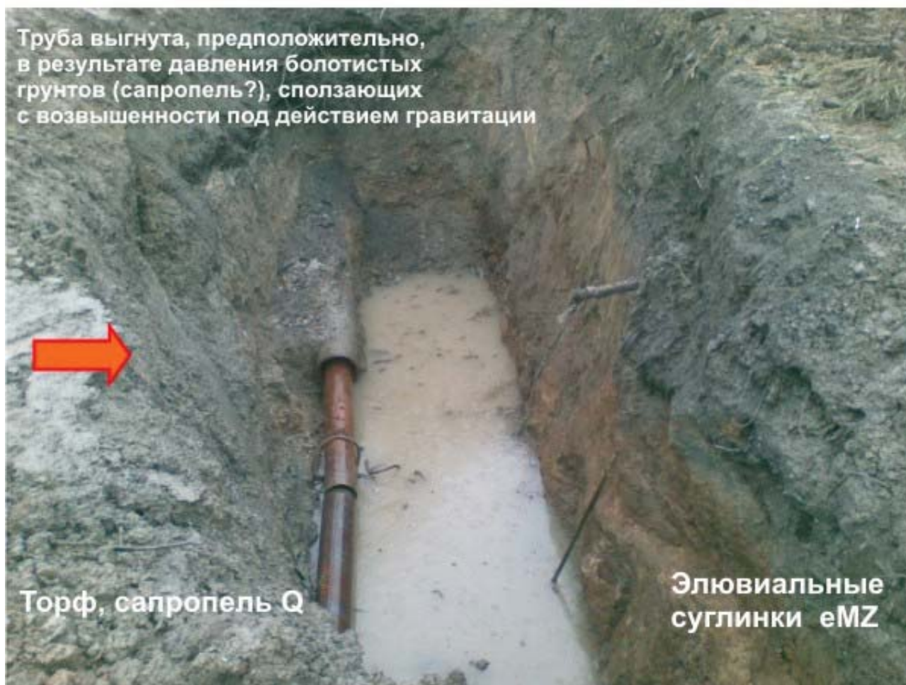
Рис. 13. Иллюстрация действия значительных горизонтальных напряжений в активном слое земной коры. Авария на городском водопроводе в районе перекрестка ул. Фрезеровщиков-Даурская в г.Екатеринбурге, август 2010 г. (Фото Осиповой А.Ю.)
