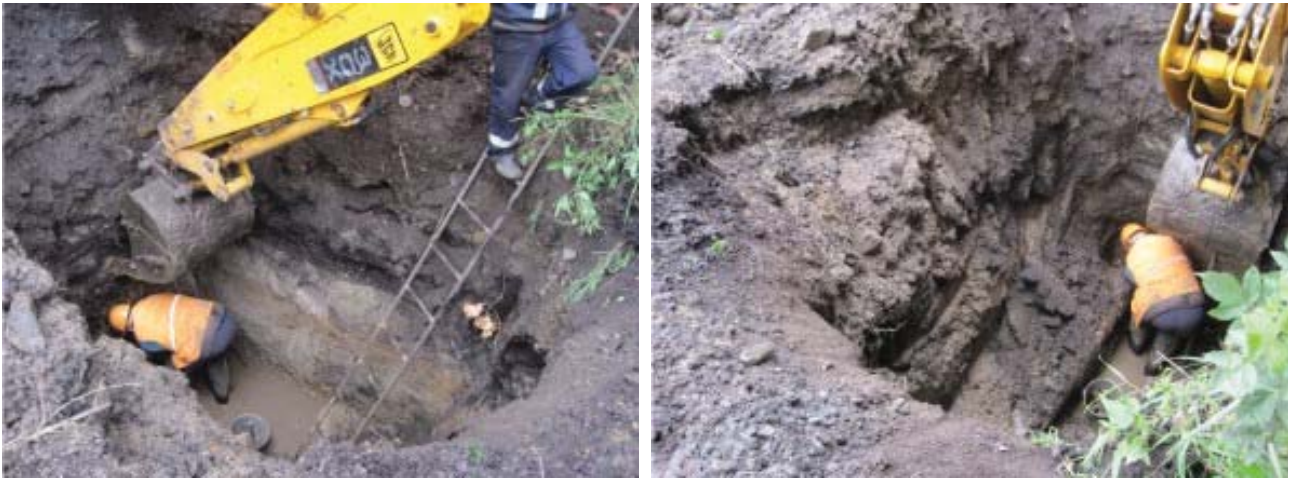
Рис. 8. Неоднородность грунтов активного слоя земной коры Екатеринбурга. Авария на ул. Амундсена, 52. Август 2010 года. В раскопе справа от сотрудника «Водоканала» относительно прочный выветрелый гранит, слева – смесь рыхлых торфянистых грунтов с дресвой гранитов. Труба повредилась в зоне контакта гранитов и рыхлых торянистых грунтов. (Фото Осиповой А.Ю.)
