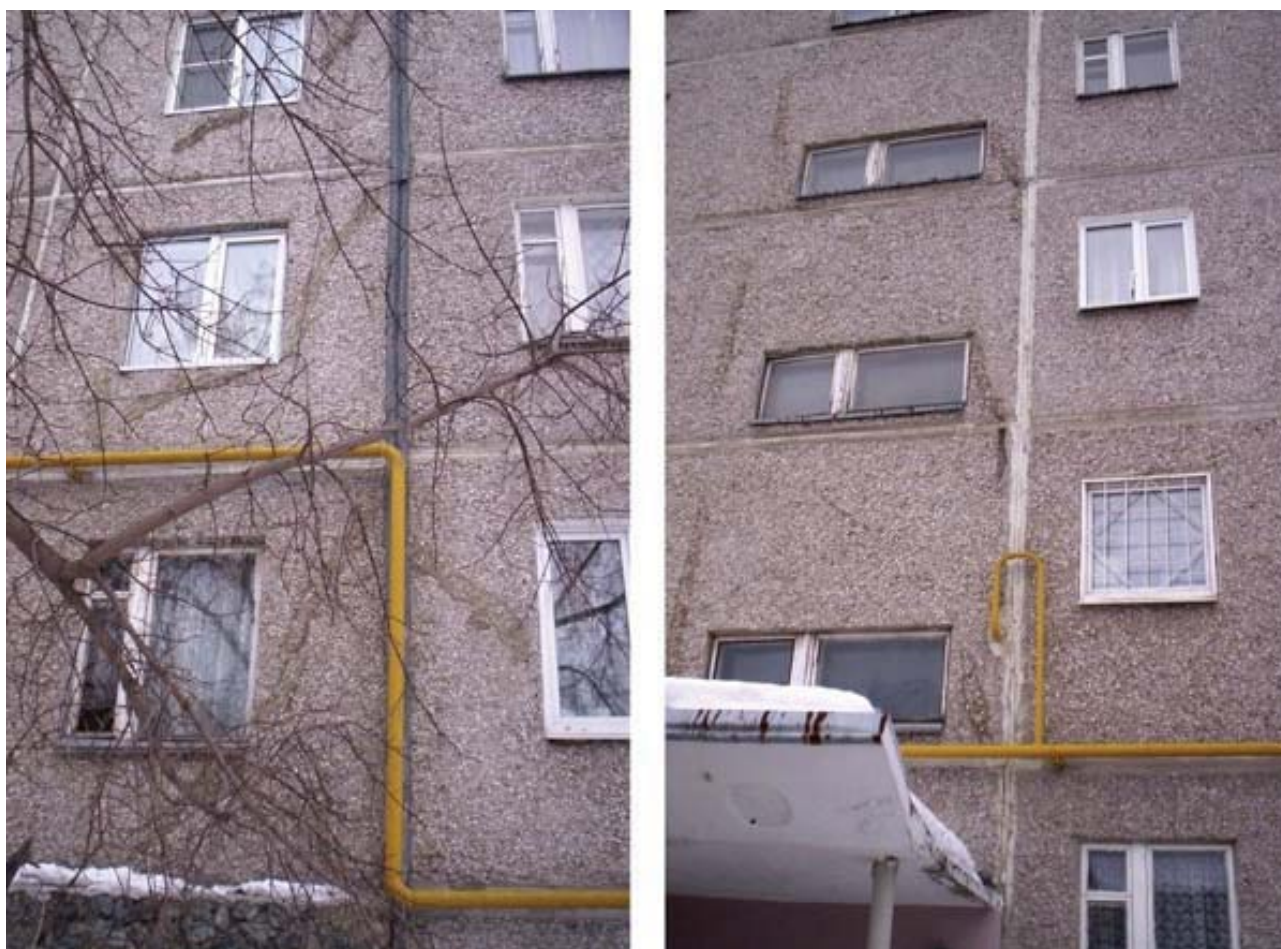
Рис. 3. Серия протяженных трещин, прослеживаемых до 4 этажа, на 9-этажном жилом доме по ул. Гагарина в Берёзовском
