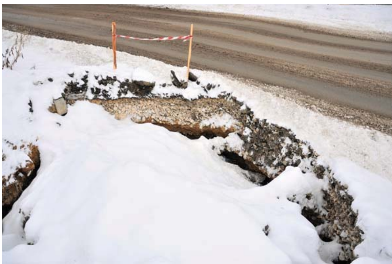
Рис. 1. Провал участка дороги по ул. Ленина в Берёзовском
