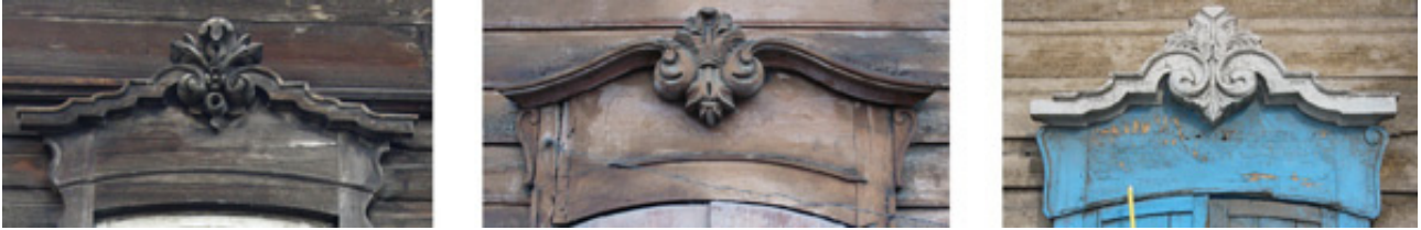
Рис. 22. Примеры лобаней первого типа: ул. Бабушкина, 2, ул. Бабушкина, 19а, ул. Баррикад, 31 (фото Н. Зарубиной)
