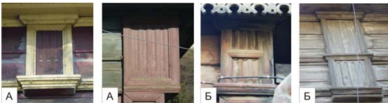
Рис. 15. Триглиф с бороздками, декорированный филенками: а) целостный (ул. Марата, 23; ул. Каштаковская, 43); б) с горизонтальной филенкой посередине триглифа (ул. Декабристов, 13; ул. Напольная, 2). Фото В. Асманкиной
