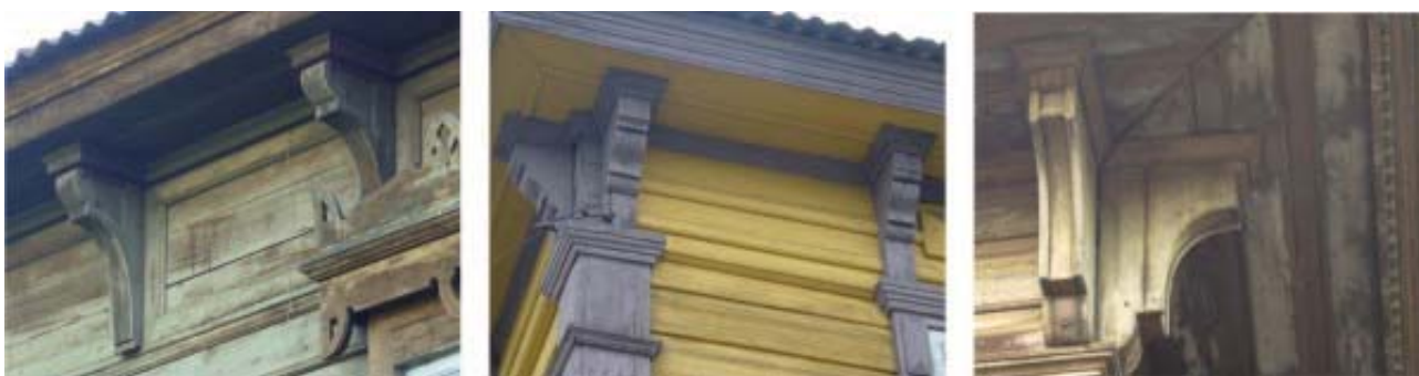
Рис. 27. Кронштейны разнообразных криволинейных профилей: ул. Гагарина, 34, ул. Каландаришвили, 17а; ул. К. Либкнехта, 82 а. Фото В. Асманкиной
