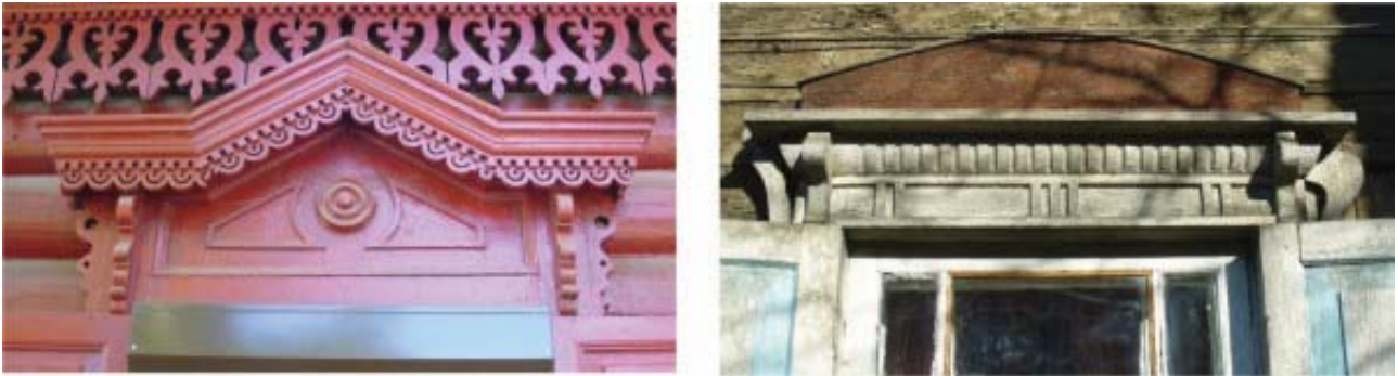
Рис. 32. Кронштейны под карнизом наличника: ул. Киевская, 32а, ул. Лермонтова, 5. Фото В. Асманкиной
