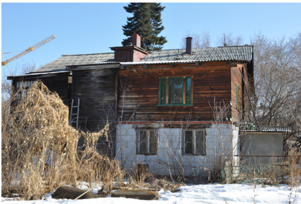
Рис.19. Дом на ул. Декабристов, 69в. Современный двухэтажный пристрой с северо-западной стороны дома. Расширение жилых площадей существующей постройки имеет смысл только при высокой надежности последней. Фото В.Н. Куршаковой
