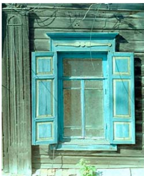
Рис. 15. Фрагмент ампирного дома на ул. Карташова (ул. Ярлыковская). Томск. Начало XIX в. Фото автора. 2002
