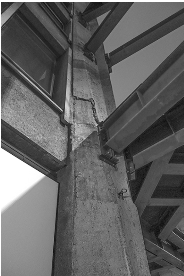
Рис. 3. Фрагмент крепления металлического каркаса к ж/б каркасу башни через слой штукатурки с розовой мраморной крошкой. Металлический каркас сделан вокруг башни для установки на нем лесов для наружного ремонта фасадов. Впоследствии планируется к использованию для размещения на нем сада с зелеными ароматными травами и кустарниками. Фото: В.Н. Филиппов
