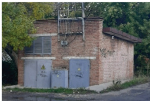
а) Трансформаторная подстанция
